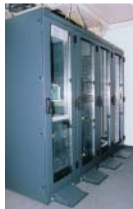
Server im Rechneraum (Ber.52)
